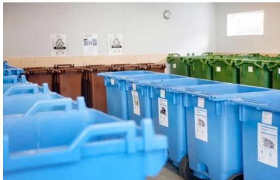
Figur 6 Separata kärl i avfallsutrymme för mat- och restavfall och utsorterade förpackningar och returpapper. Exempel från Umeå. Foto: AB Bostaden i Umeå
