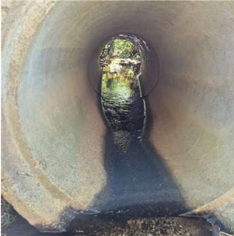
Figur 18. Vandringshinder 2 består av en kort betongtrumma som ligger löst i vattendraget.
