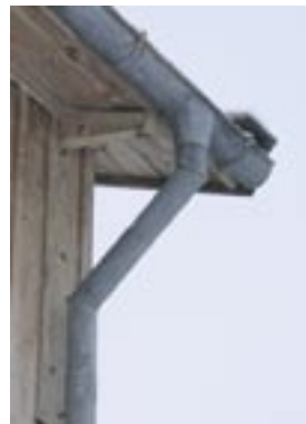
Äldre stuprör med skarpt knä.
