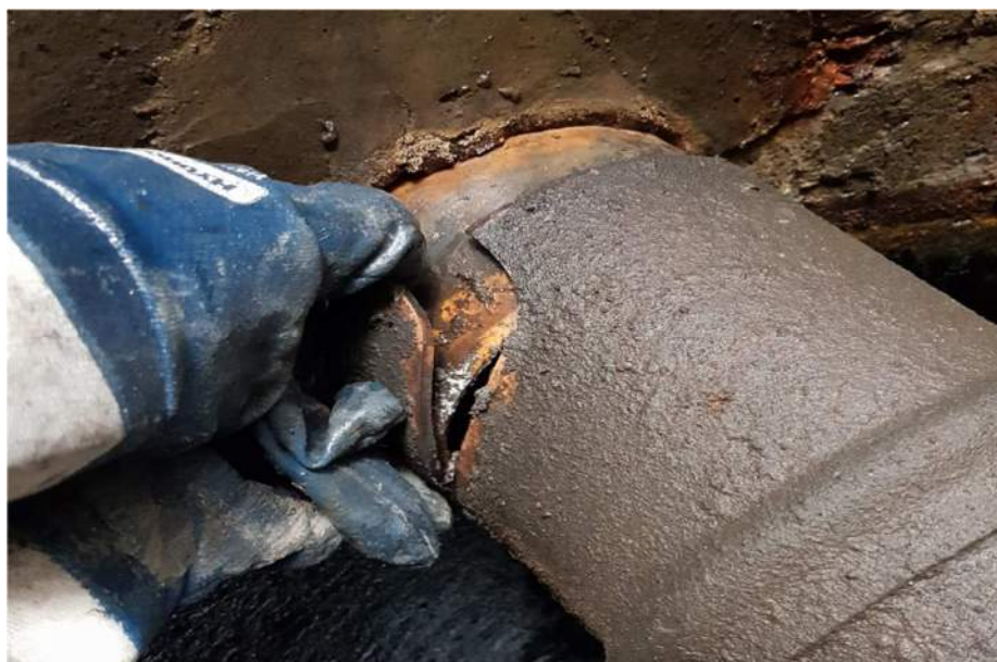
Figur 4. Bild från 5-årskontroll 2018 av oljeavskiljare "Motorcentralen Scania"
