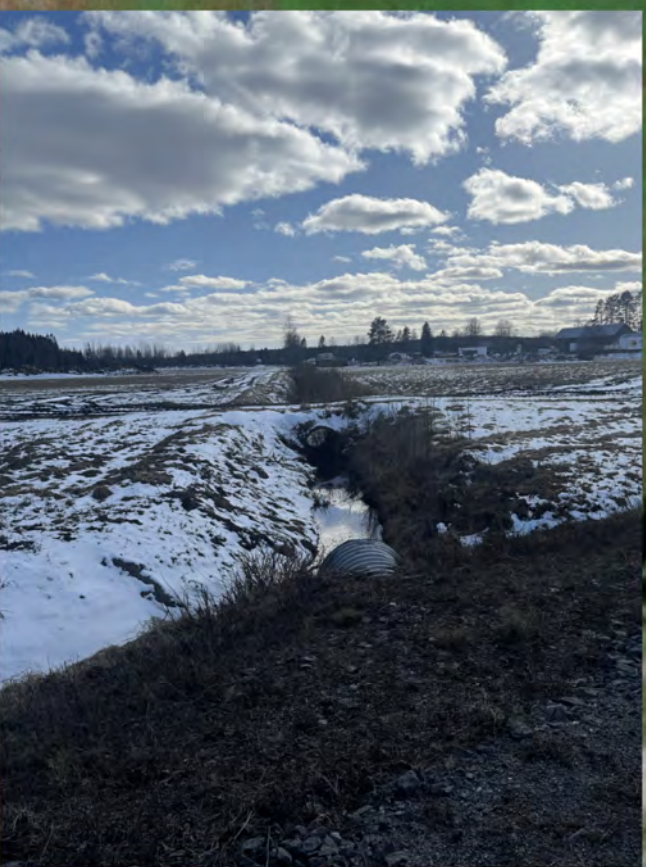
Trumma under överväg D: 1000mm
