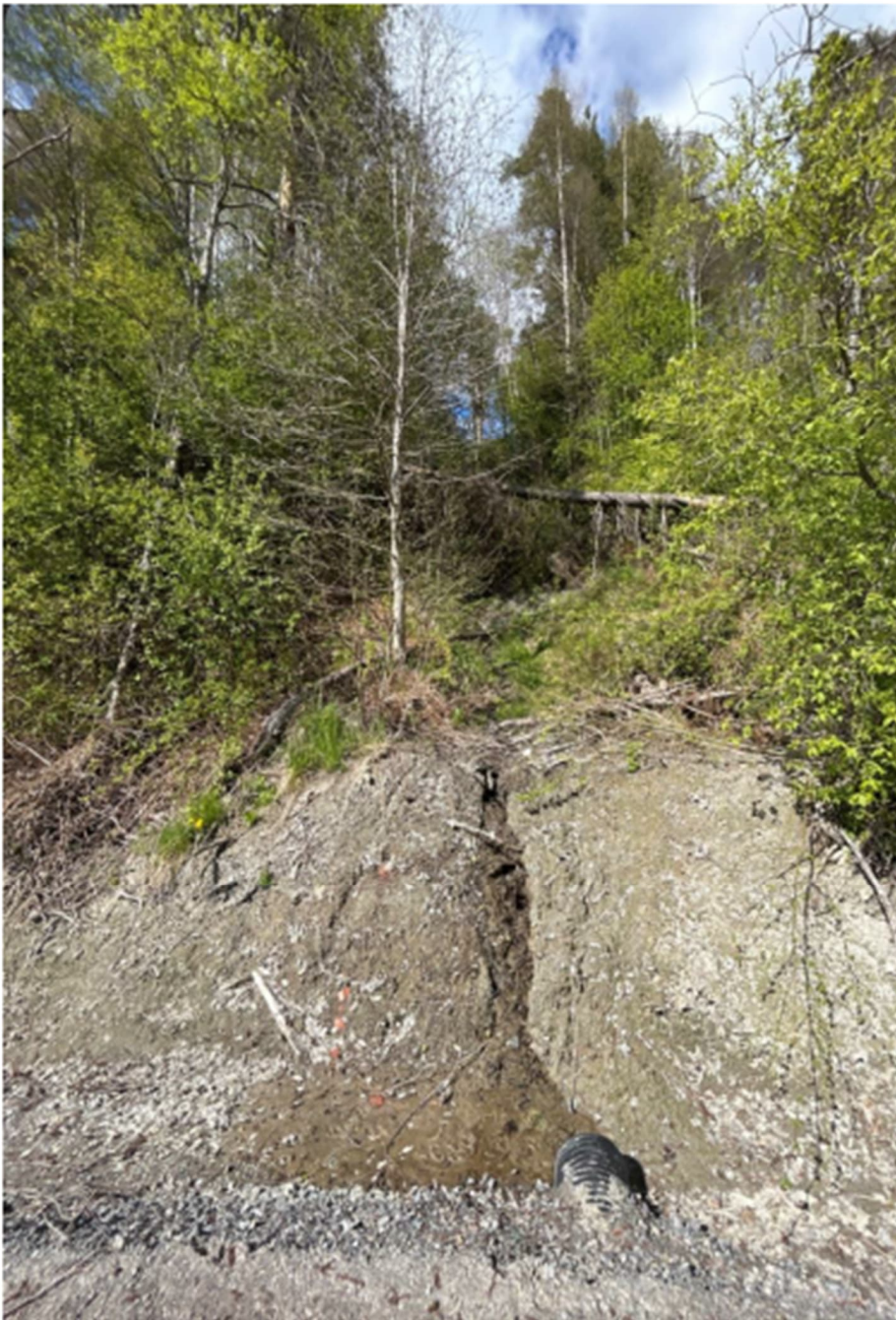
Figur 4-12. Ytvattenserosion och ravinbildning i sand.
