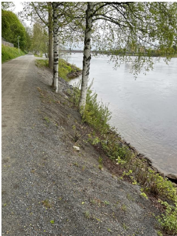
Figur 4-12. Pågående erosion i strandlinjen, sannolikt från varierande vattenstånd och isrörelser, ovan erosionsskyddet.
