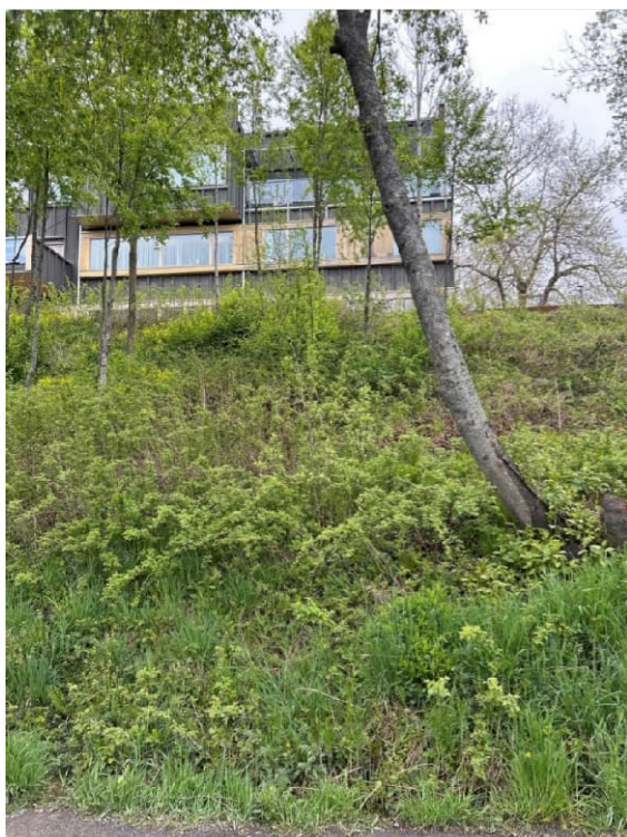
Figur 4-13. Den övre delen av slänten påvisar måttlig erosion, här exempel från ca sektion 0/100.
