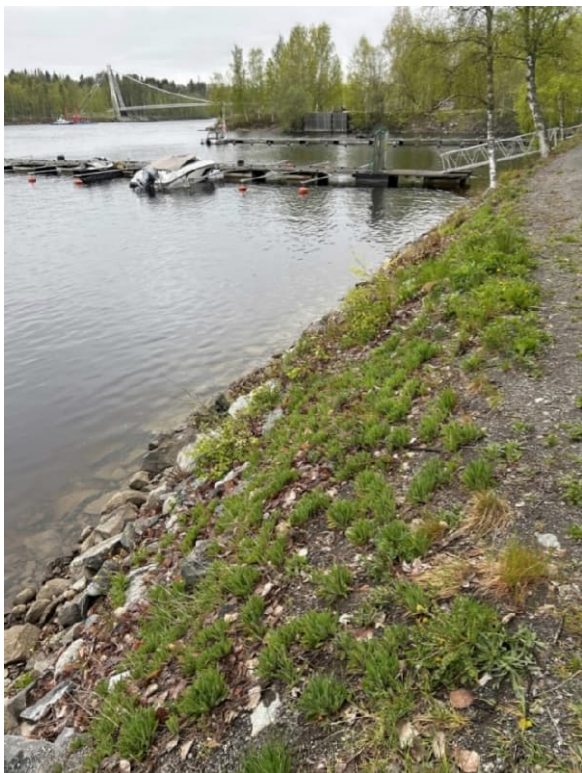
Figur 4-17. Måttlig erosion, sannolikt till stor del yterosion och synligt erosionsskydd i släntfot nedan strandpromenaden. Exempel från ca sektion 1/200.
