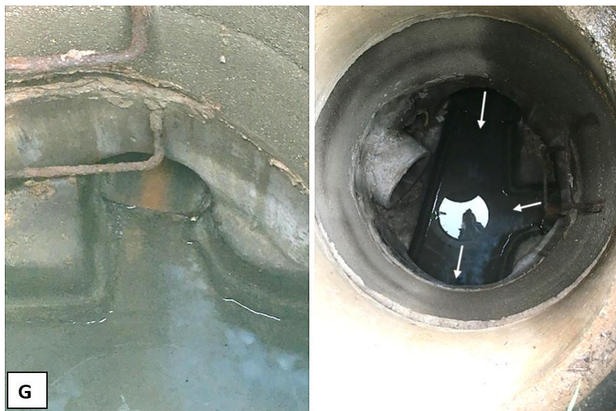
Figur 21. Till vänster: Inkommande ledning 300 mm från väst. Till höger: Nedstigningsbrunnens utformning med inkommande ledning från norr, inkommande ledning 300 mm från väst, inkommande ledning 300 mm från öst (proppad) och utgående ledning 600 mm i sydlig riktning. De vita pilarna redovisar flödesriktningen för dagvattnet.
