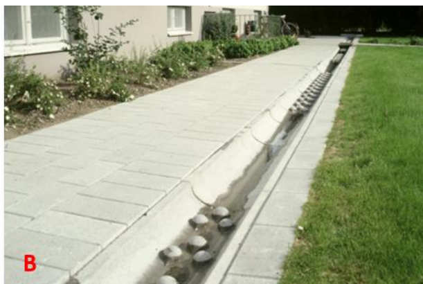
Figur 21. En hårdgjord lökränna. Avleder dagvattnet kontrollerat och med ökad självrensning i och med lökarna. Lökarna ger god självrens även vid låga flöden. Bilden är från S:t Eriks.
